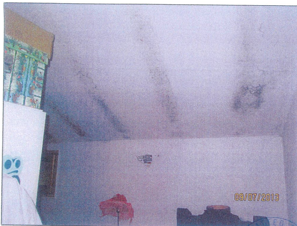
Foto n° 9 - Locale di sgombero - Infiltrazioni
