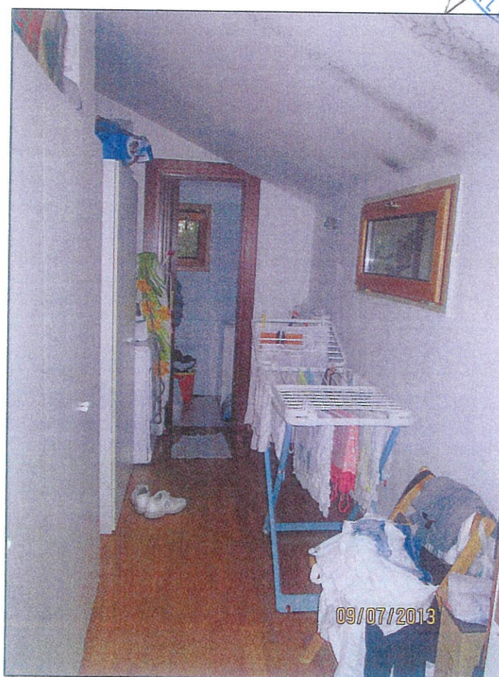
Foto n° 10 - Locale di sgombero - Infiltrazioni
