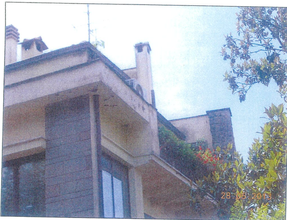
Foto n°3 - Facciata - Particolare Distaccamenti Tinte
