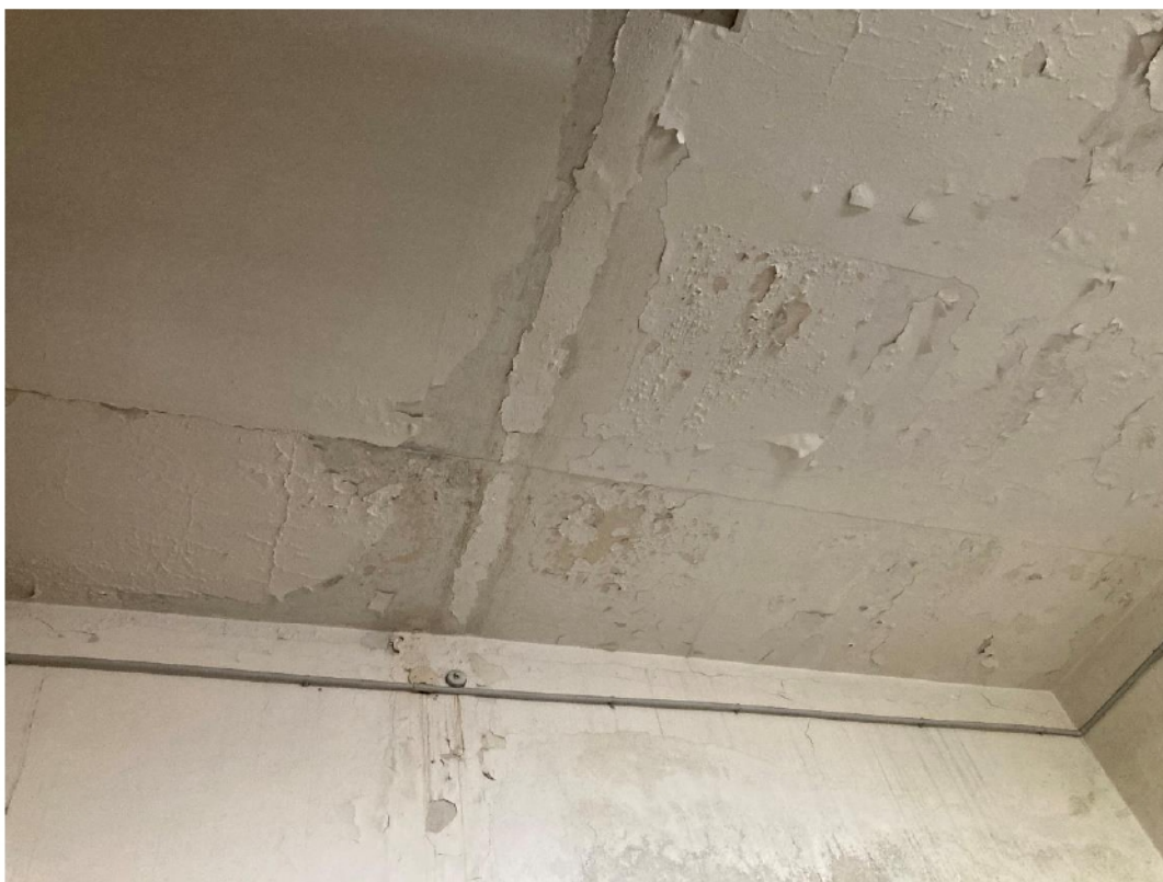
Foto n. 6: Dettaglio ammaloramenti a parete e a soffitto
