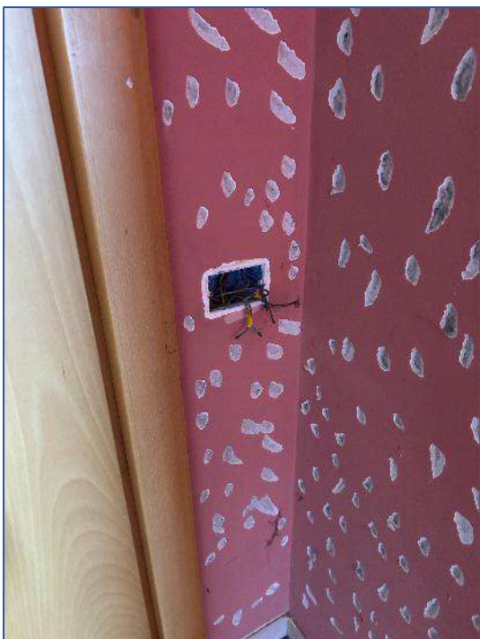
Foto 24 - dettaglio impianto elettrico
