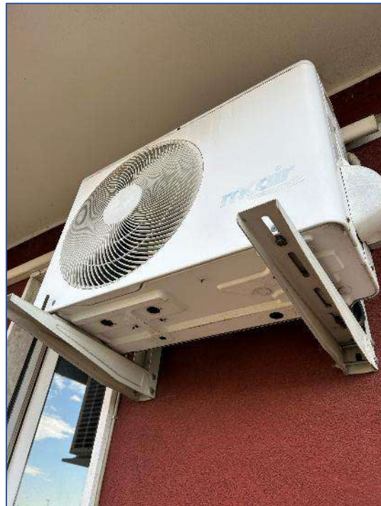
Foto 35 - dettaglio impianto di condizionamento
