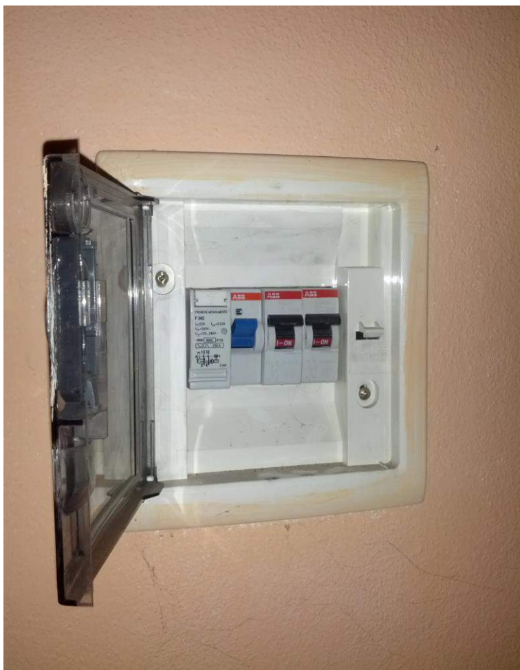
foto 11 – piano terra: quadro elettrico
