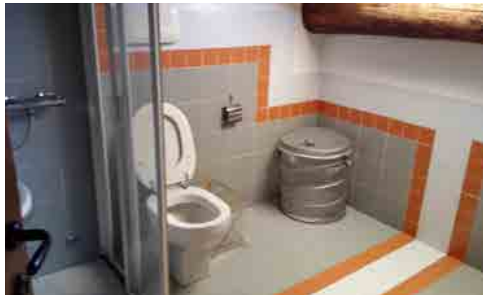
Ripostiglio (bagno abusivo), piano secondo lotto 9.
