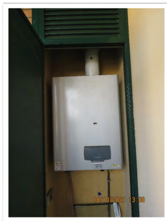
Caldaia murale a gas e vista dal balcone del soggiorno.
