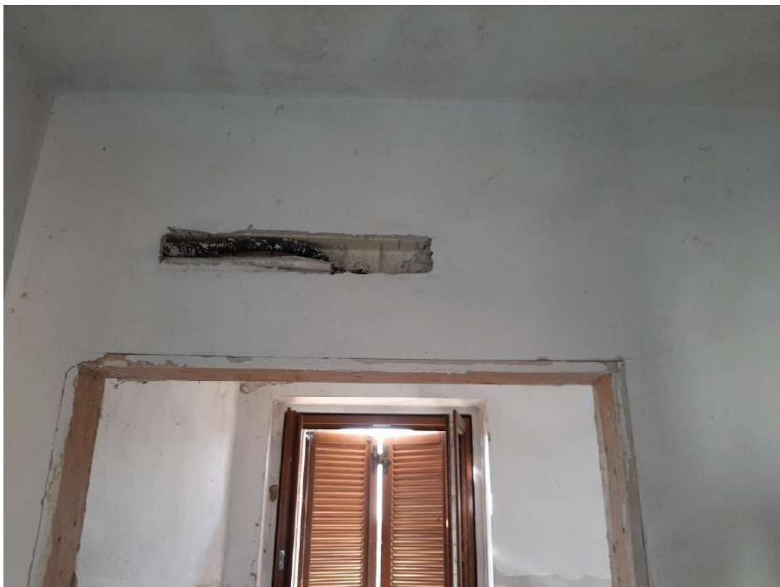
2.22 Vista interna LOTTO 1 - Villetta nord – disimpegno piano primo (particolare predisposizione climatizzatore)
