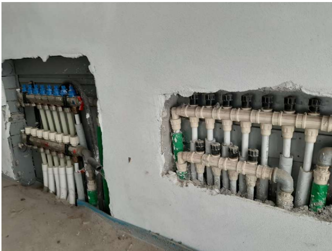
2.25 Vista interna LOTTO 1 - Villetta nord – particolare collettori impianto riscaldamento a pavimento e impianto idraulico
